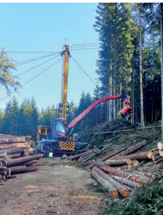
Moderne Seilkrantechnologie – Technik aus Österreich, die weltweit zum Einsatz kommt und begeistert.
